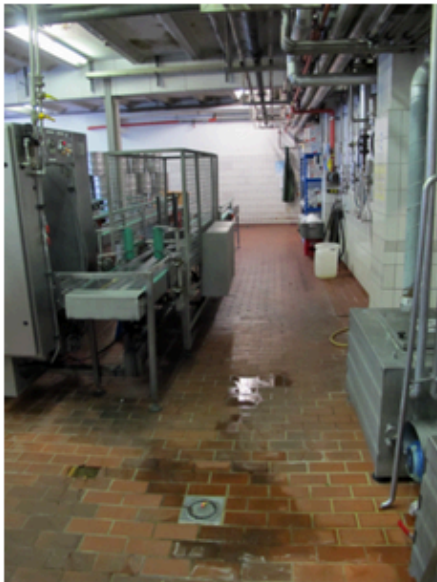
Der alte, defekte Fliesenbelag vor der Sanierung...
